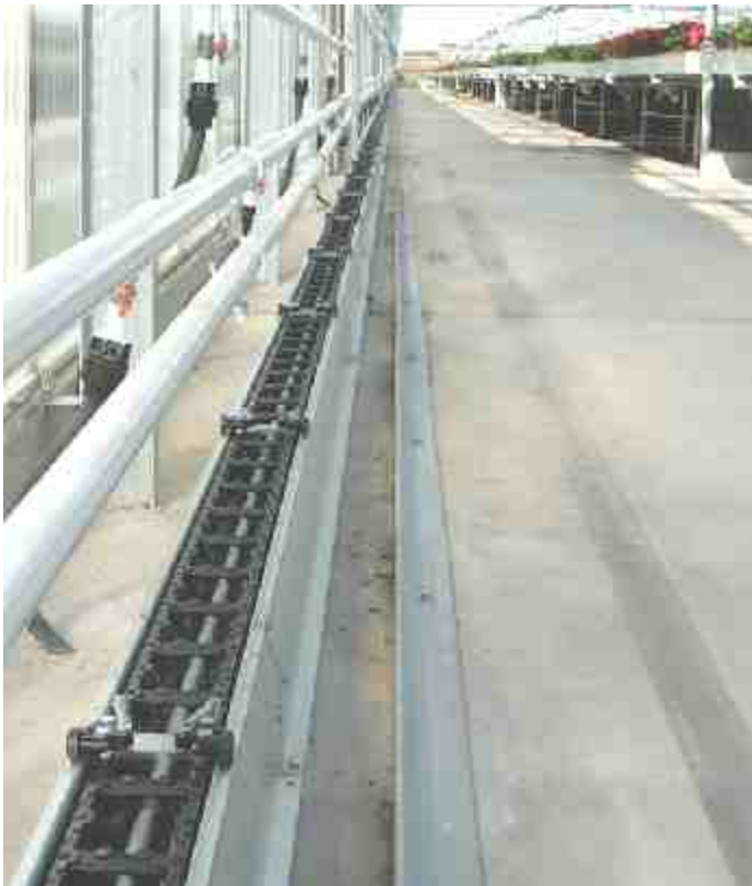
Anwendungsbeispiel Gewächshaus: Relative Luftfeuchtigkeit 80-100% Verfahrweg 150 m
