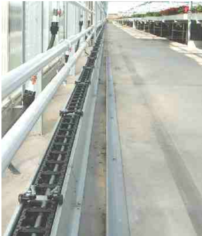
Anwendungsbeispiel Gewächshaus: Relative Luftfeuchtigkeit 80-100% Verfahrweg 150 m
