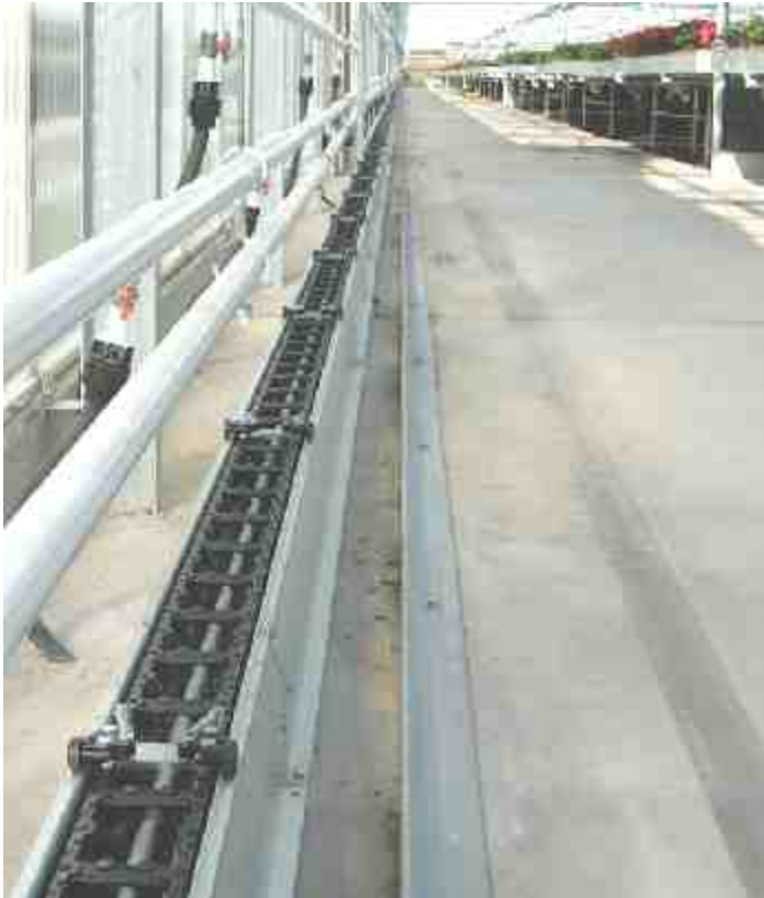
Anwendungsbeispiel Gewächshaus: Relative Luftfeuchtigkeit 80-100% Verfahrweg 150 m
