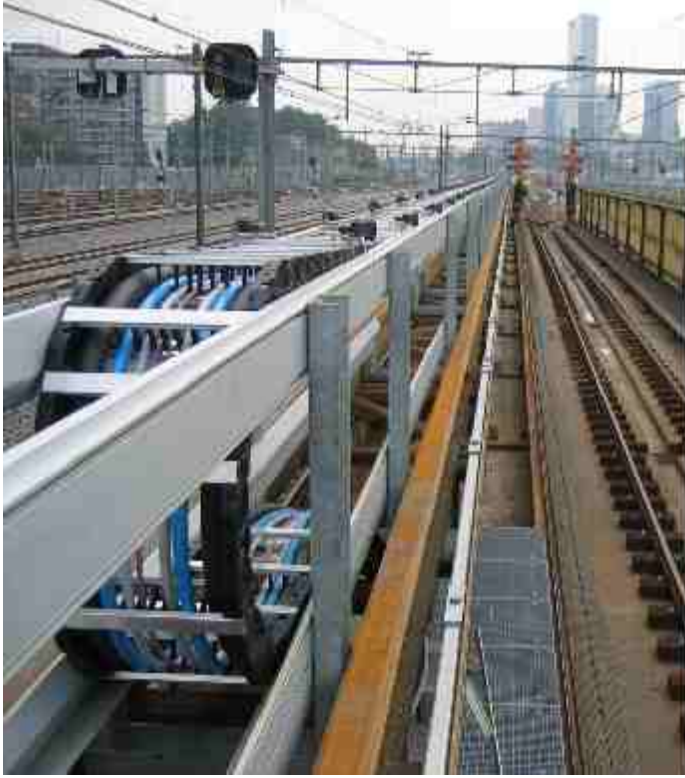
Anwendungsbeispiel Zugwaschanlage: Freie Bewitterung Extreme Beeinflussung durch Medien (Waschemulsionen) Verfahrweg 180 m
